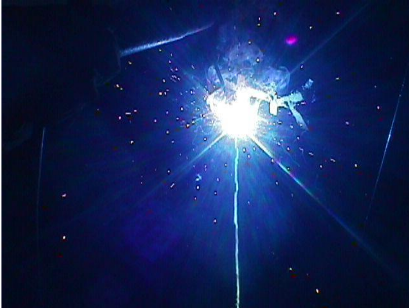
Solda sendo executada com eletrodos excessivamente úmido
